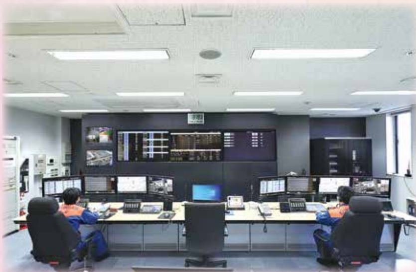
栗原市消防本部 通信指令センター
