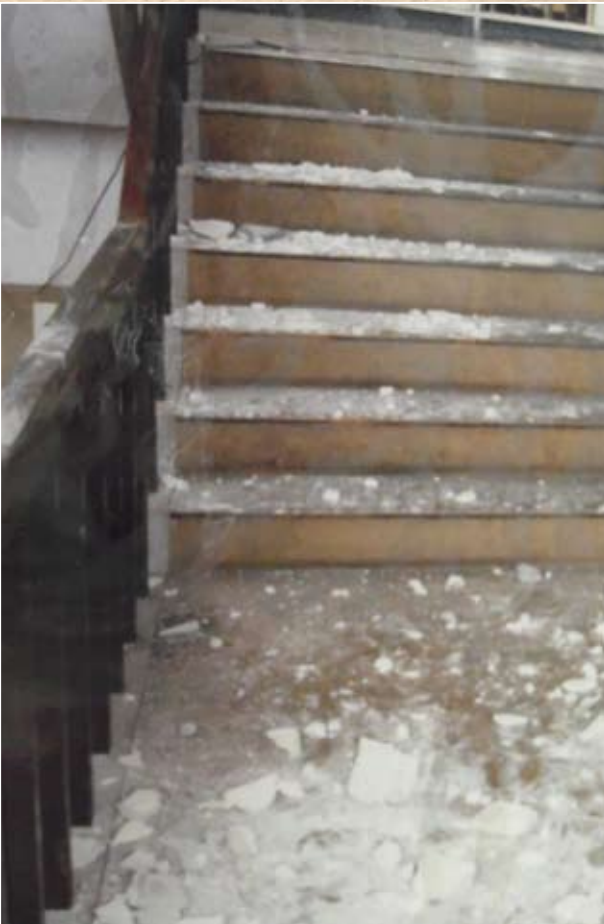
昭和53年 宮城県沖地震の被害
