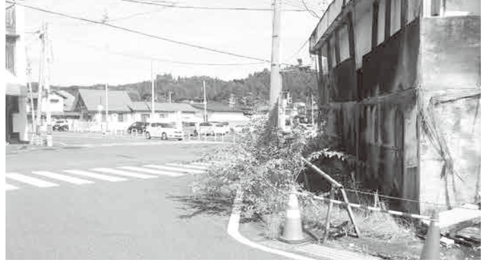
岩ヶ崎中心部の荒廃した建物
