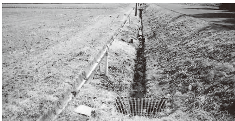
改修が望まれる排水路
