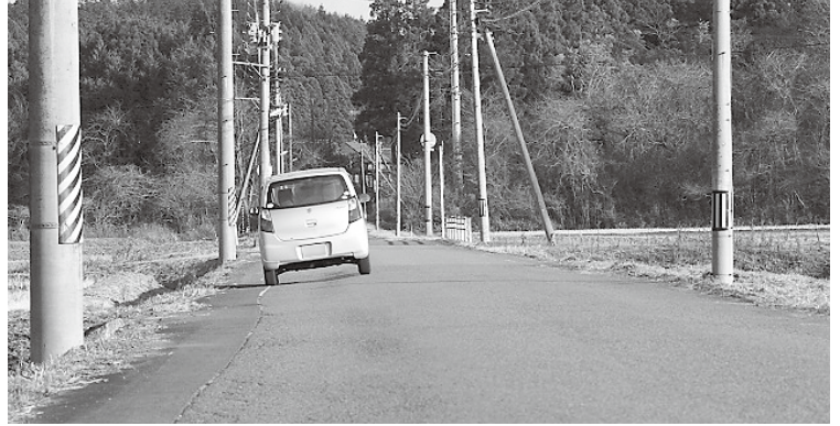
路肩の沈下で車が傾く
