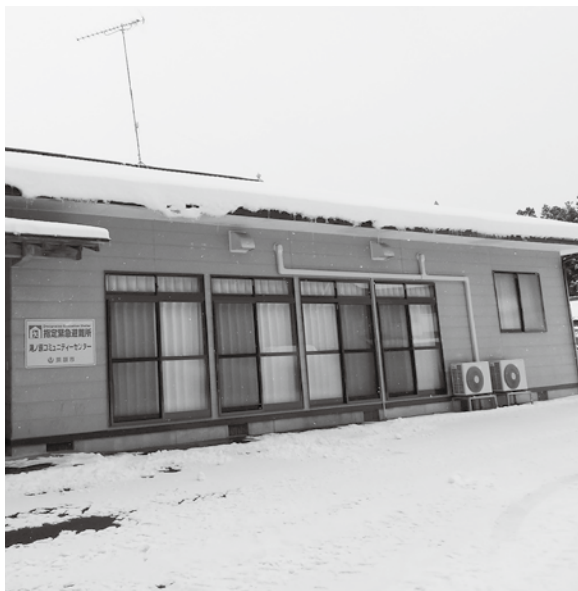
修繕が必要なコミュニティセンター
