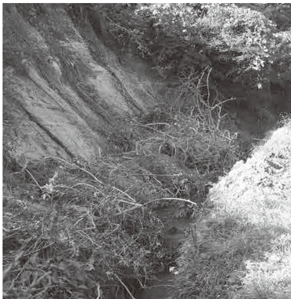
水路にのり面崩落
