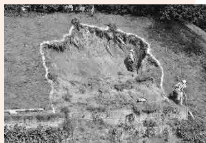
のり面が崩れた築館小学校
