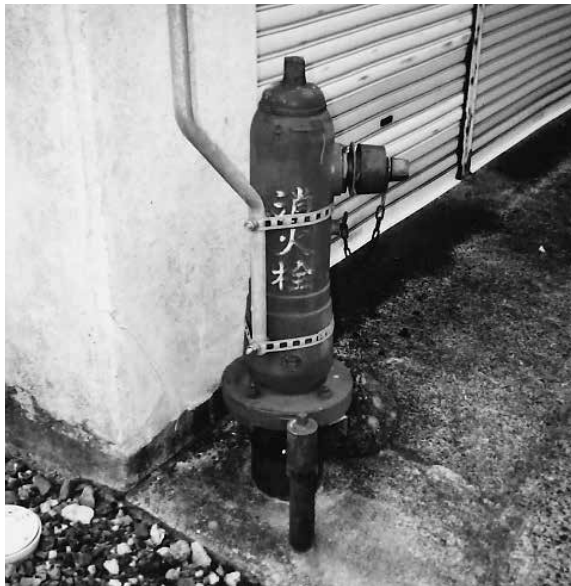
緊急時に活躍する消火栓
