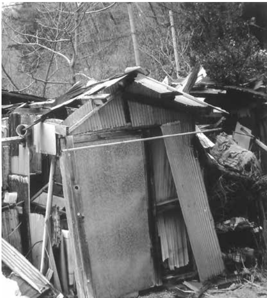
倒壊した空き家
