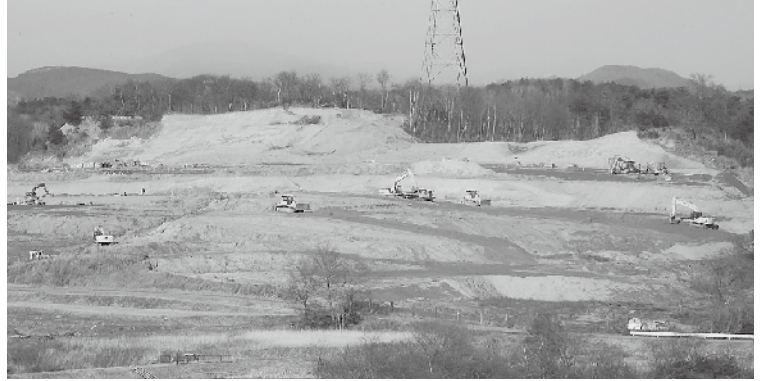
削られる山肌、心配される土砂流出
