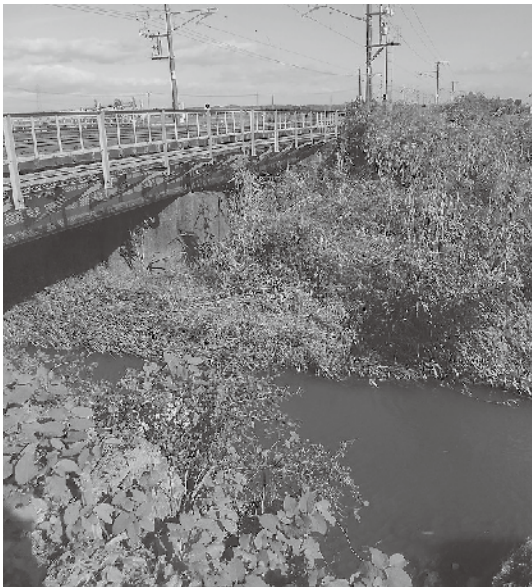
東北本線 落堀川の鉄橋下の堆積土砂と支障木
