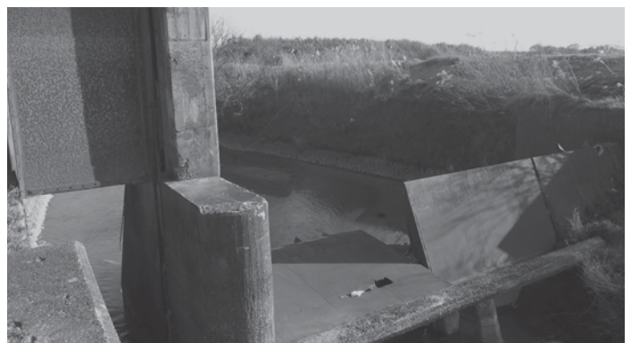
熊川堰 早急な撤去が求められる
