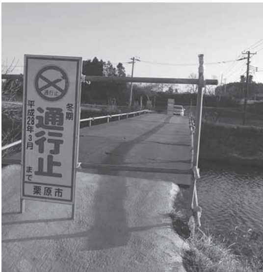
完成を待つ落橋
