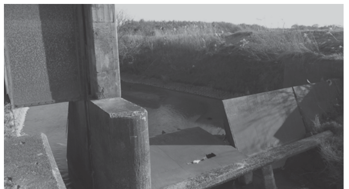
熊川堰 早急な撤去が求められる
