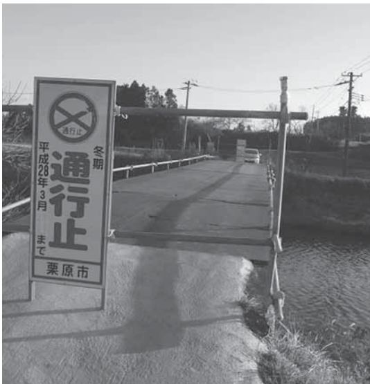
完成を待つ落橋
