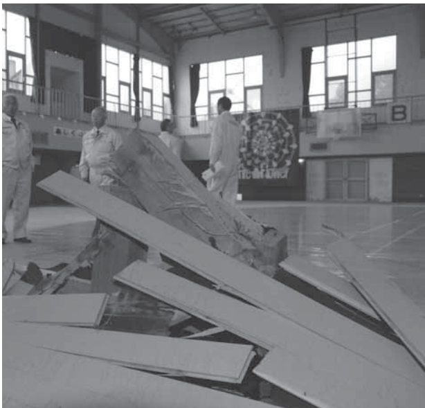
水害で床が持ち上がった旧鷺沢中体育館
