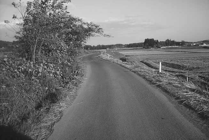
舗装修繕が待たれる市道
