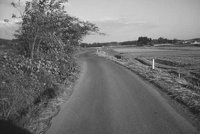
舗装修繕が待たれる市道
