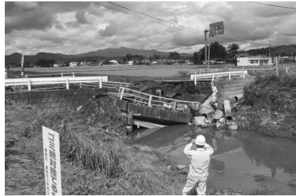
流出した熊川橋
