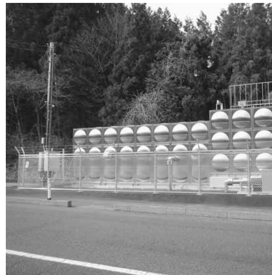
一迫地区堰場ポンプ場
