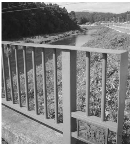
整備が待たれる鶯沢二岐橋上流部
