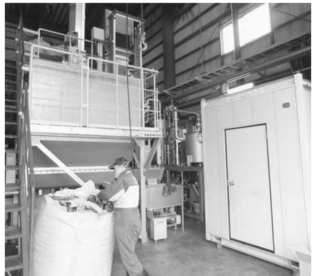
木質チップのバイオマス発電施設 (岩手県奥州市)
