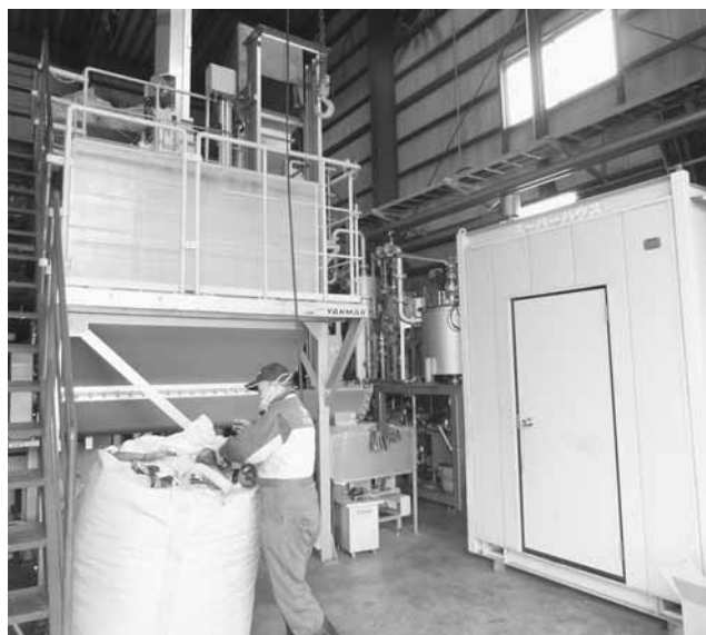
木質チップのバイオマス発電施設 (岩手県奥州市)
