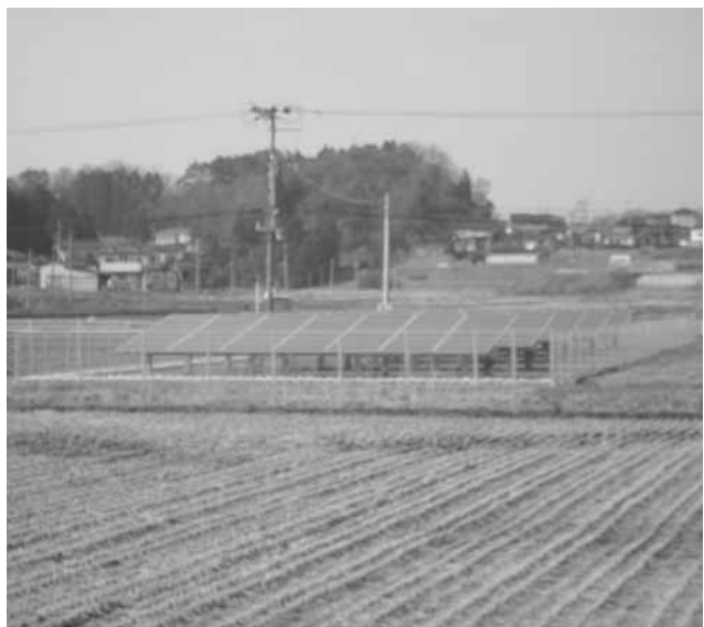
農地の隣接地に設置されている太陽光パネル
