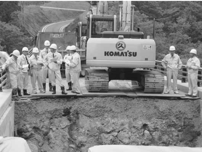
陥没した現場
