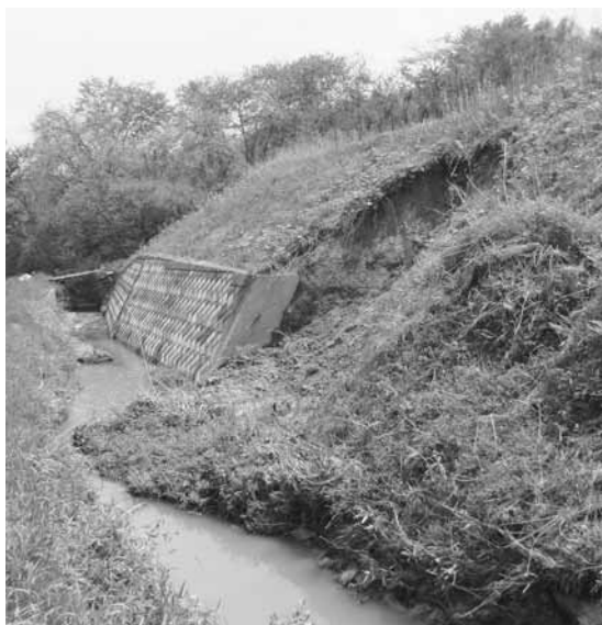
5月の豪雨で崩れた栗駒姫松地区（倉沢水路）
