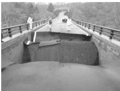
陥没した取り付け道路
