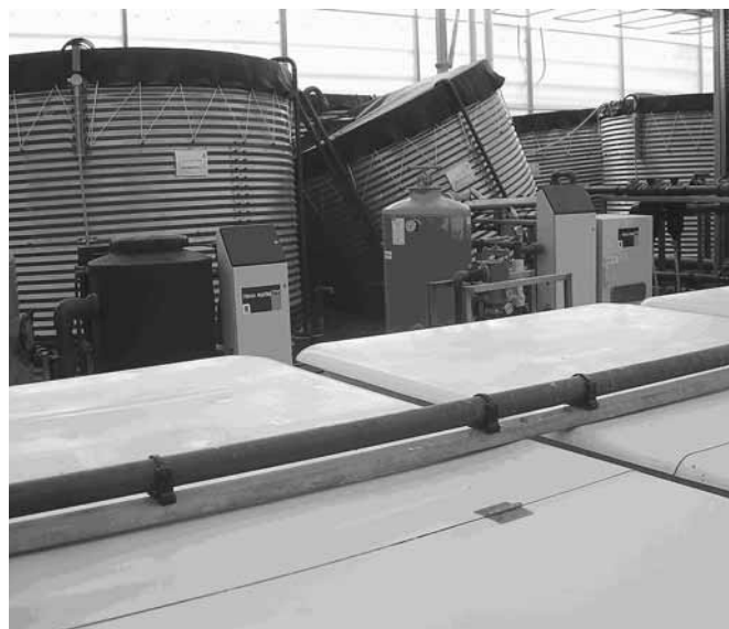
被災したパプリカ生産施設(高清水)
