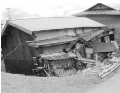
解体撤去が待たれる被害建物
