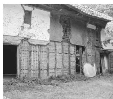
震災で歴史的建造物の被害が甚大
