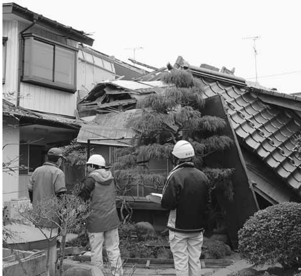
4月7日の余震で倒壊した民家
