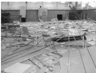
天井が落下した志波姫中学校体育館
