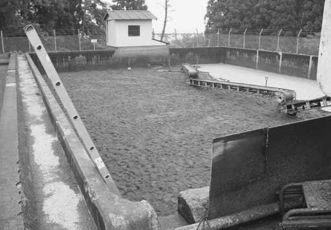
荒町浄水場のろ過池
