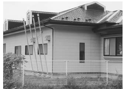
改修が待たれる集会所のトイレ
