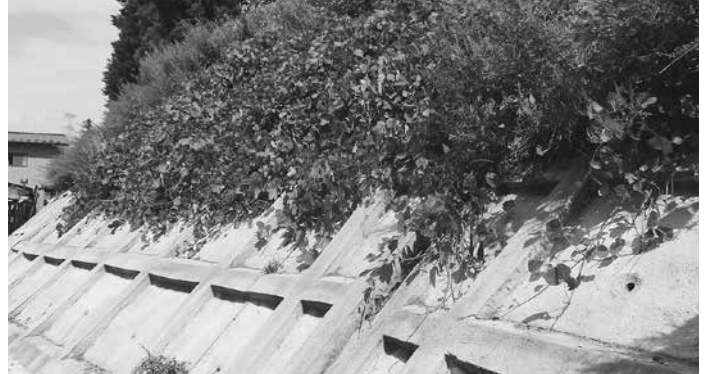
事業完了後に雑草が繁茂（桜田蛇壇地区）
