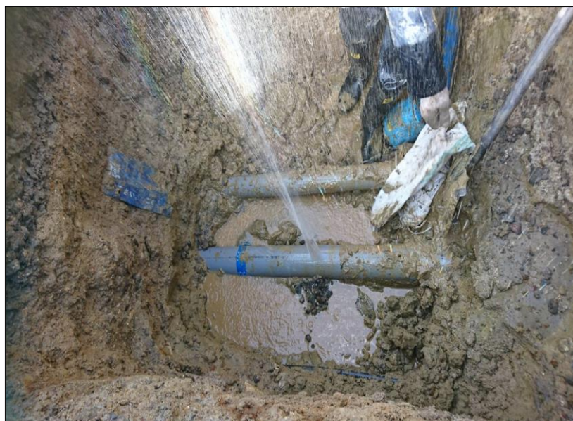
破損し漏水した水道管
