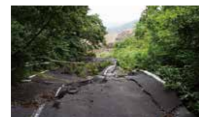
▲災害によって寸断された道路
