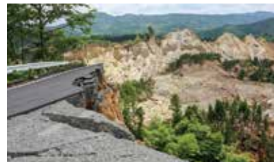
▲荒砥沢地すべり地内の道路寸断現場
