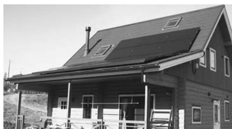
▲太陽光発電システム
