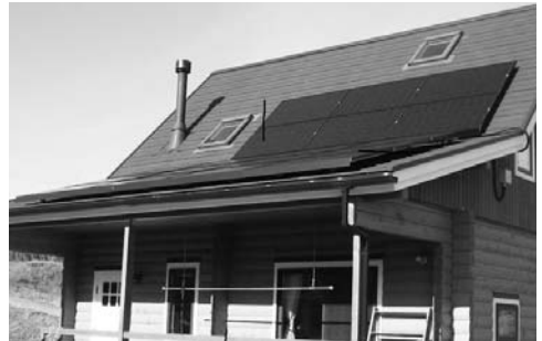
▲屋根の上に設置された太陽光発電システム
