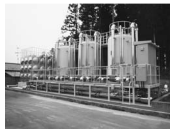
▲御駒堂浄水場の高度浄水処理施設
