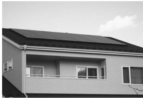
▲屋根の上に設置された太陽光発電システム
