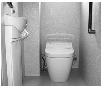
▲トイレの水洗化で快適な生活を！
