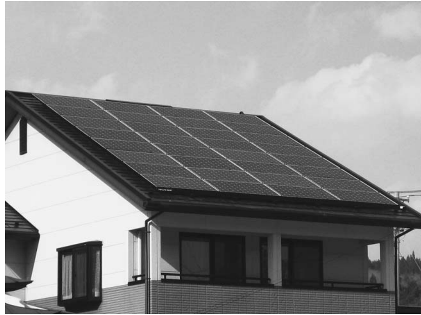
▲屋根の上に設置された太陽光発電システム
