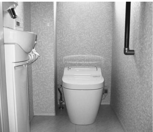
▲トイレの水洗化で快適な生活を！
