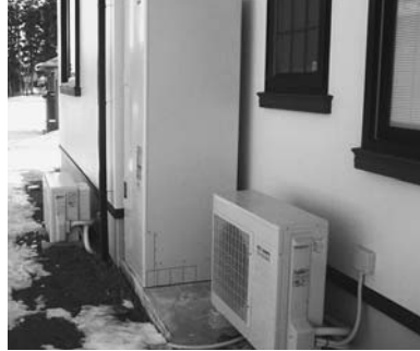
▲エコキュートを設置した例
