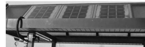
▲駅前のバスターミナル屋根に設置した太陽電池
