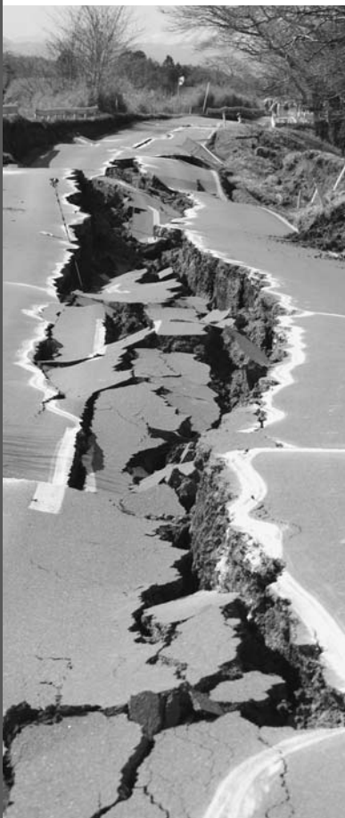
▲路面が崩壊し、通行止めになった市道沢辺大岡線(若柳地区)
