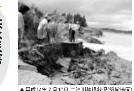
▲平成14年7月10日 二迫川破堤状況(築館地区)
