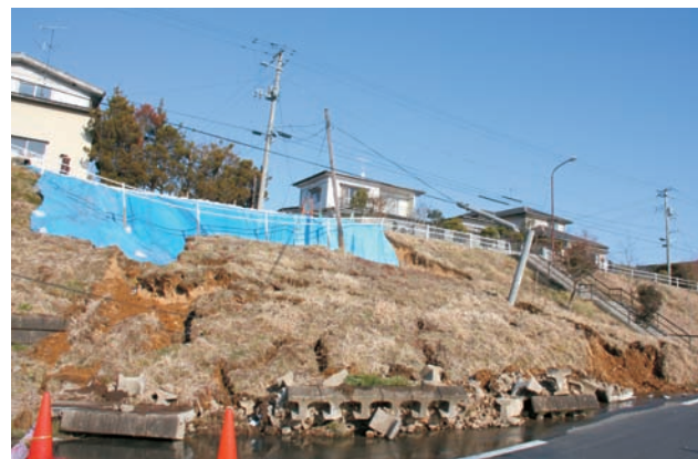
▲道路法面の崩落(瀬峰宮小路原)
