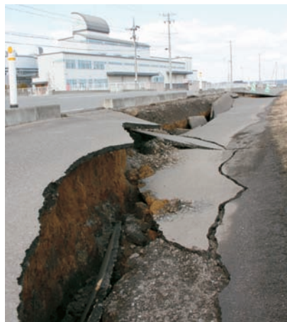
▲大きく陥没した歩道(若柳八木)
