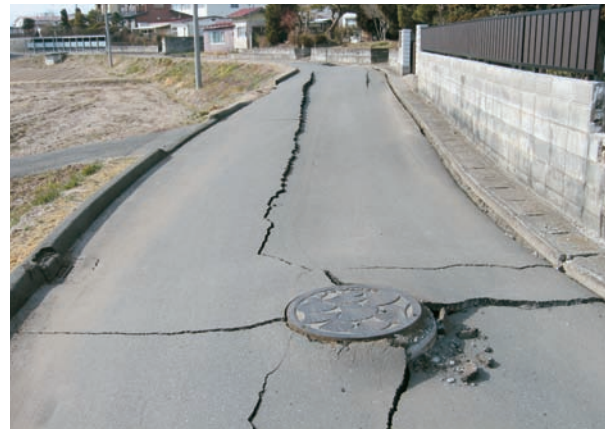
▲マンホールが隆起したことで、路面まで大きく亀裂が入りました(築館・市道金華山線)
