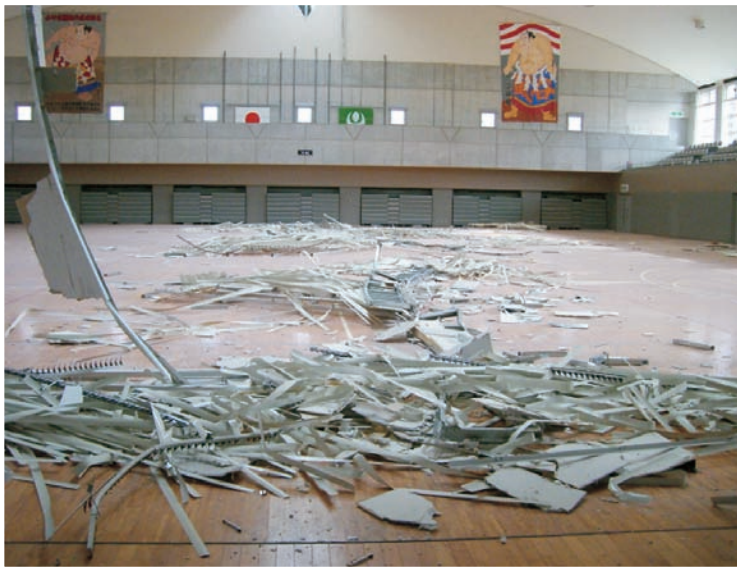
▲天井が落下した栗駒総合体育館
