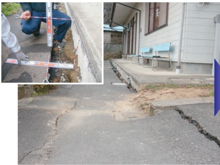
▲敷地が大きく割れた集会施設(瀬峰上富)
