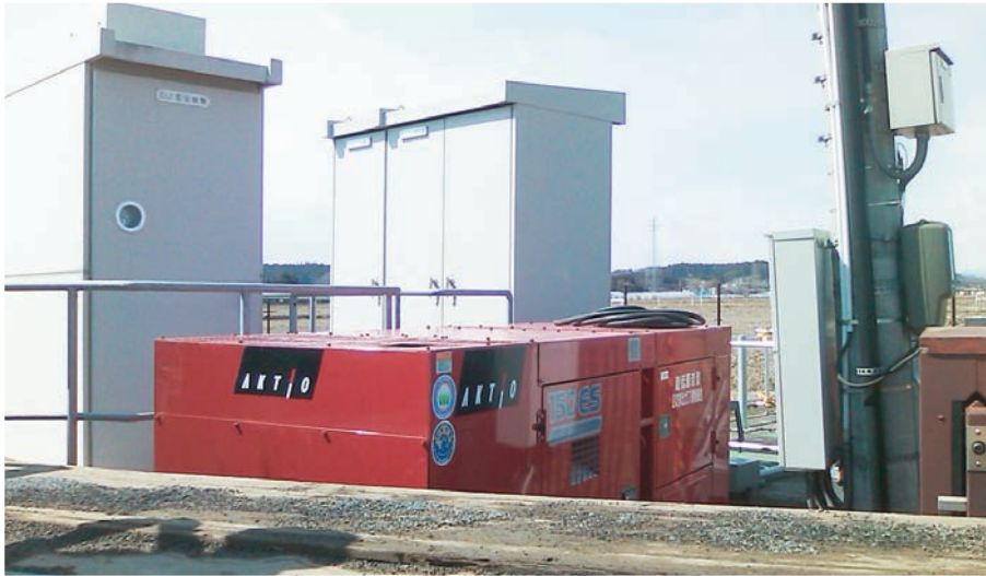
▲災害時支援協定企業による支援 (発電機の優先リース)
