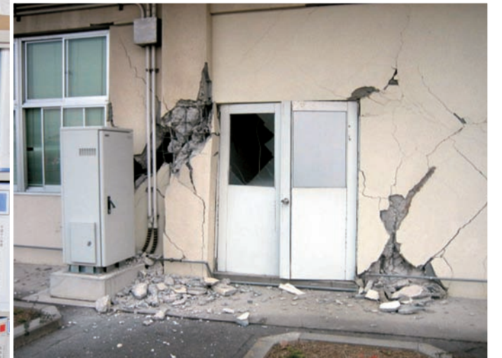
▼柱や壁が崩れ落ち利用できなくなった志波姫総合支所
