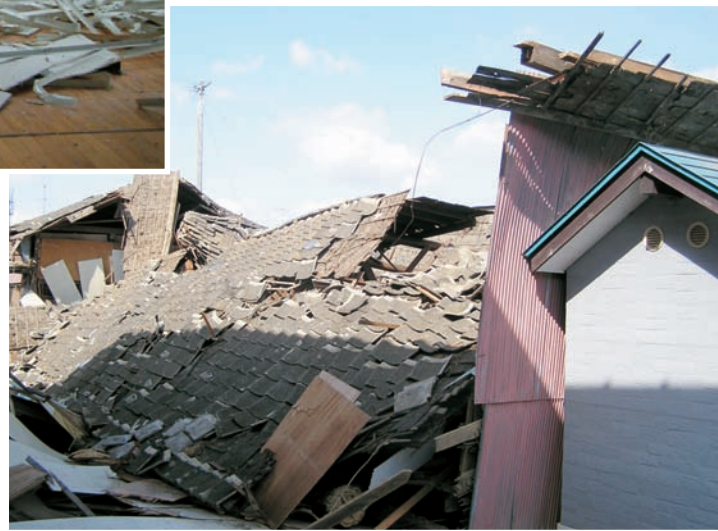
▲建物が倒壊した若柳歴史民俗資料館
