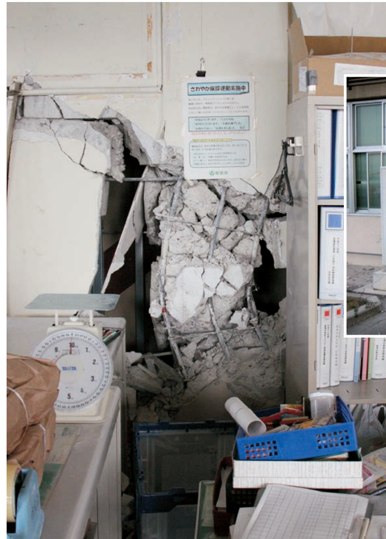
▲鉄筋コンクリート製の柱が変形し、鉄筋がむき出しになった高清水総合支所
