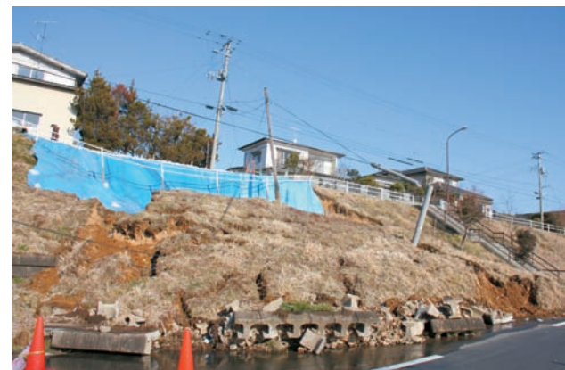
▲道路法面の崩落(瀬峰宮小路原)
