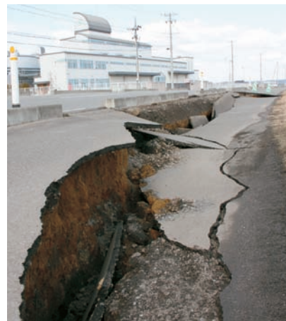
▲大きく陥没した歩道(若柳八木)
