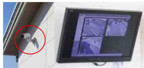
防犯カメラと監視モニター
