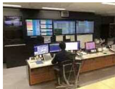
更新予定の消防指令装置
