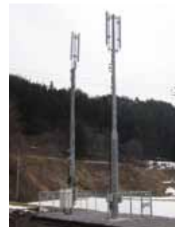
花山金沢地区に整備した携帯電話基地局 (平成25年度)
