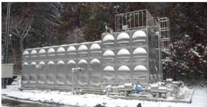
統合に向けて整備が進む水道施設
