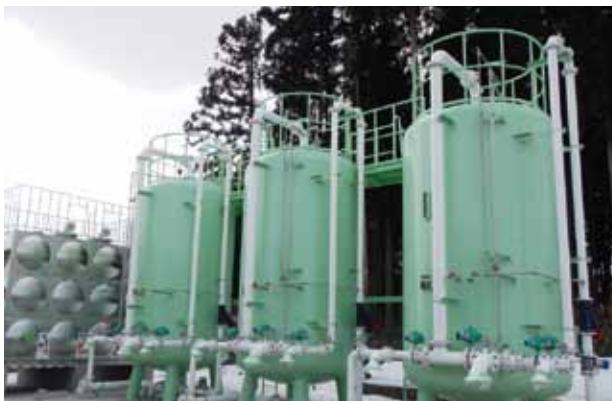
平成25年度に設置した志波姫地区の御駒堂浄水場の高度浄水処理施設
